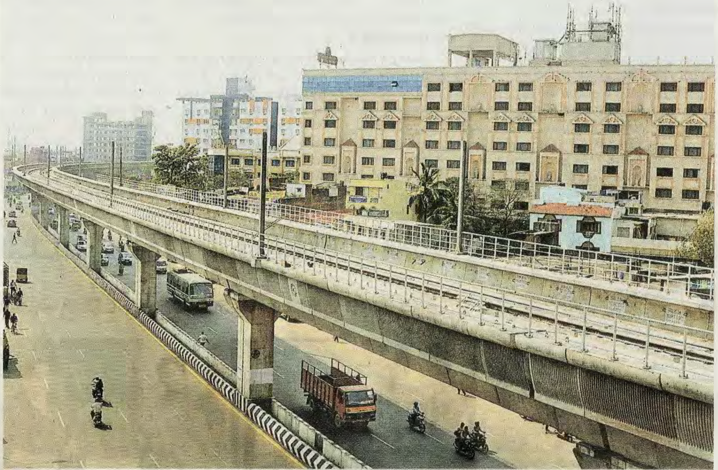
■ சென்னை மெட்ரோ ரயிலுக்கான தண்டவாளம் அமைக்கும் பணி நிறைவடையும் நிலையில், அடுத்த கட்டமாக, பக்கவாட்டு பகுதியில் கைப்பிடி கிரில் அமைக்கும் பணி துவங்கியுள்ளது. இடம்: கோயம்பேடு, நூற்றடி சாலை.
